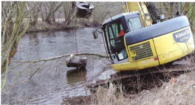
Abb. 11: Der Baum wird nebst Ankerstein in die Saale eingebracht. Es herrscht Niedrigwasser (Quelle: G. Kemmler)
